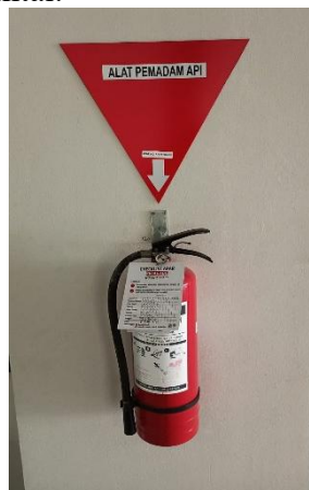
Gambar 3.21 Fire Extinguisher Sumber: Dokumentasi Perusahaan
